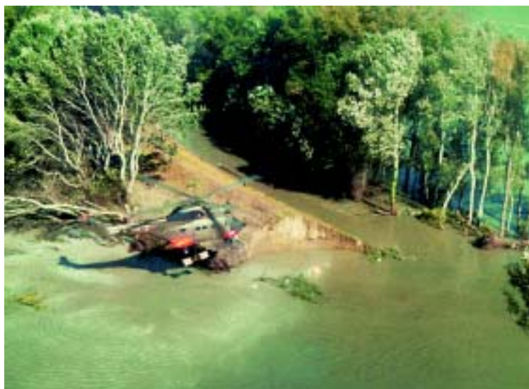
Photo 2.11 (source : Service Navigation Rhône-Saône) - Les phénomènes d'érosion interne (terriers traversants, passages de conduite) ont été reconnus comme à l'origine de la totalité des 16 brèches déplorées sur les digues de Camargue lors des deux crues du Rhône de l'hiver 1993-1994.
