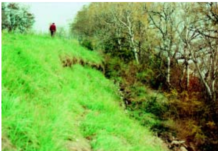
Photo 2.15 (source DDE 13) – Glissement à la décrue du talus côté fleuve de la digue rive gauche du Grand Rhône au lieu-dit Mas de la Ville.
