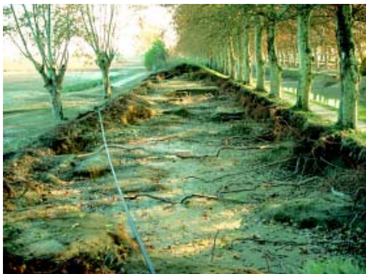
Photo 5.4 – Le développement des racines d'arbres dans le corps de digue n'est pas un leurre. Les brèches de Sallèles-d'Aude ont permis de constater que les racines de platane traversaient de part en part le remblai de la digue.
