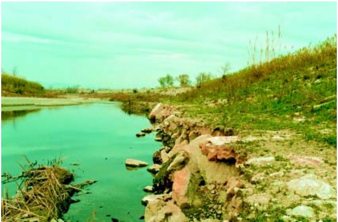
Photo 2.7 – Dignes de l'Agly : bêche parafouille de pied de berge partiellement emportée suite à la crue des 12-13/11/1999.
