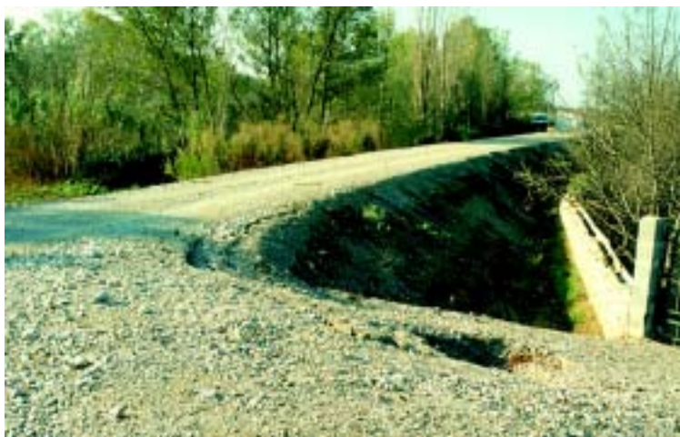
Photo 3.9 – Fontis et affaissement en côté val du couronnement de la digue de Cuxac d'Aude après la crue des 12-13/11/1999. Un passage de conduite est à l'origine du désordre.
