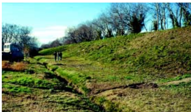
Photo 3.10 – Inspection de la digue du Petit Rhône en Arles après la crue du 8 janvier 1994 : indices de fuite à travers le remblai en pied de talus côté val.
