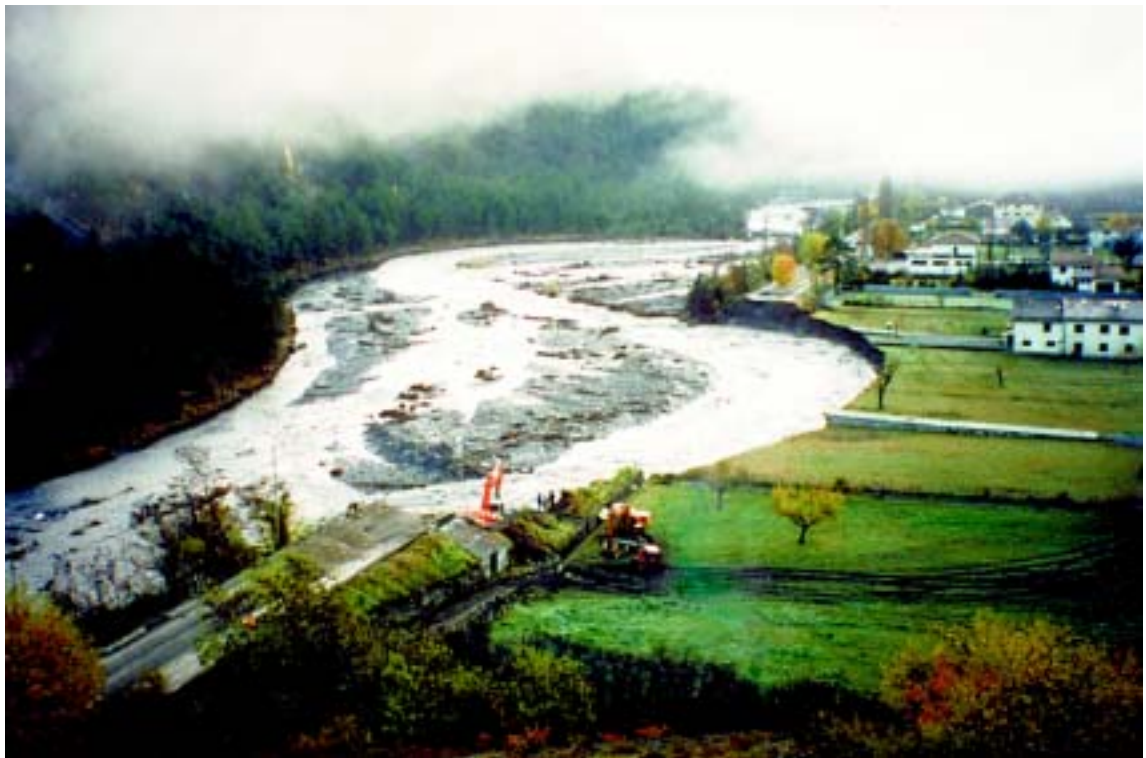
Photo 2.6 (source : ONF Alpes Maritimes) – Anse d'érosion consécutive à la crue du Var du 5/11/1994. Digue de Guillaumes (Alpes Maritimes), supportant la route départementale 2202, emportée sur plus de 150 m.
