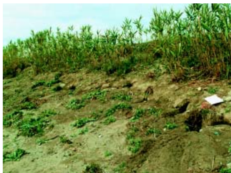
Photo 5.5 – Les terriers peuvent être à l'origine de graves désordres s'ils sont de grandes dimensions et/ou nombreux et si la digue possède un profil étroit.
