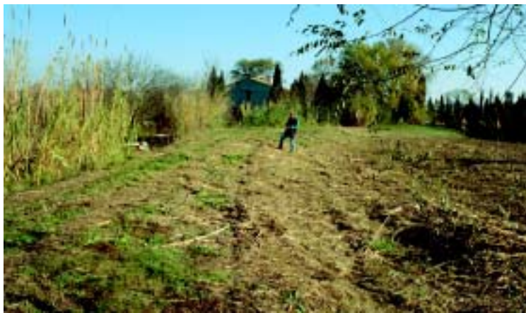
Photo 3.2 – Alignement de laisses de crue sur le talus côté fleuve de la digue de Cuxac-d'Aude, après la crue des 12-13/11/1999.
