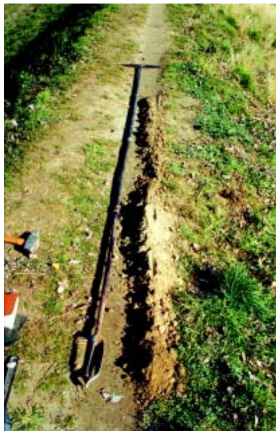
Photo 6.5 – Sondage à la tarière manuelle dans un corps de digue limono-sableux de Camargue.
