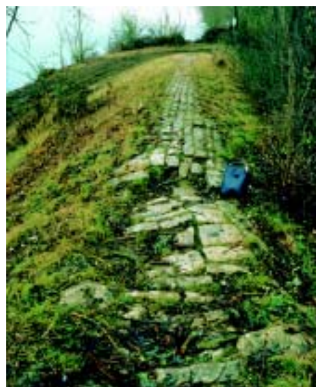
Photo 3.12 – Affaissement du couronnement perreyé de la digue de l'Allier à Moulins (Allier) : indice d'érosion interne et/ou de tassement du remblai.
