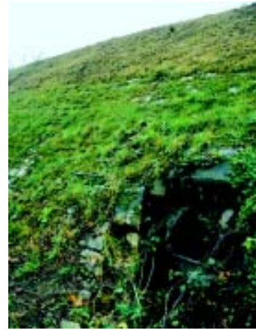
Photo 3.14 – Conduite de rejet, à clapet anti-retour, débouchant en pied du talus côté fleuve de la digue de l'Allier à Moulins.
