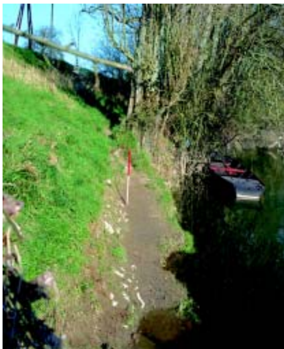
Photo 3.6 – L’affleurement d’un ancien perré de protection en pied de talus côté fleuve peut être révélateur d’une activité d’incision du cours d’eau.
