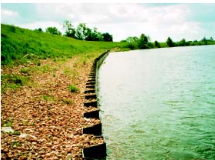
Photo 6.11 – Protection du pied de la levée rive gauche de St-Benoît (Loiret) par rideau de palplanches.
