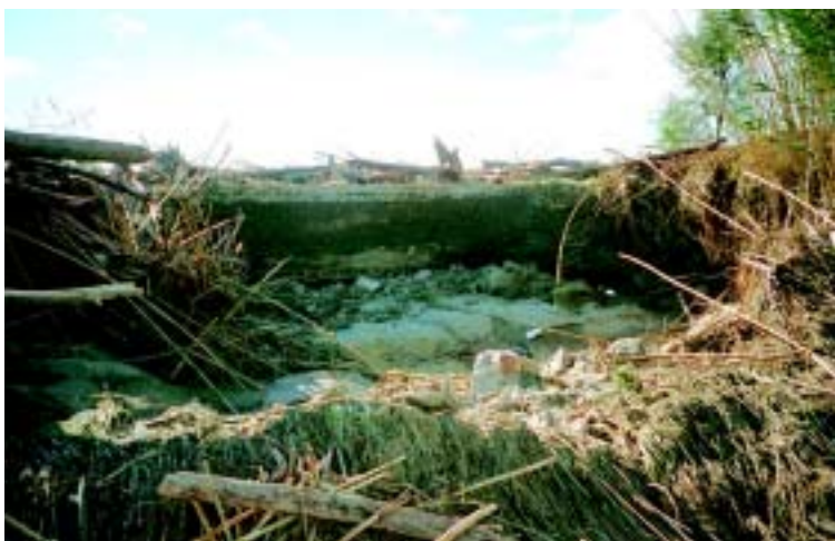
Photo 3.1 b (source DDE 66) - Détail de la loupe d'érosion de la photo précédente : couches de constitution du corps de digue.
