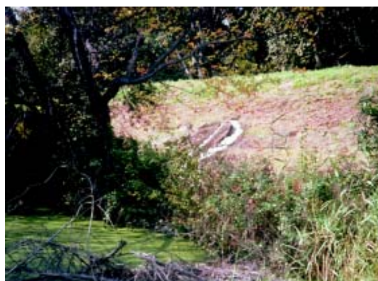
Photo 2.13 (source : Service Navigation Rhône-Saône) - Fuite sur le parement aval d'une digue de Camargue due à un terrier traversant.
