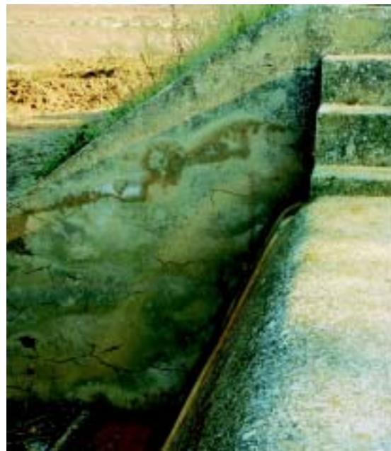
Photo 3.4 – Les déversoirs sont à inspecter minutieusement après les crues. Ici l'empreinte boueuse sur le bajoyer droit permet d'estimer la hauteur maximale de déversement.
