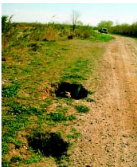
Photo 3.11 – Les fontis en crête de digue sont souvent les manifestations d'une érosion interne. Ici, deux fontis apparus en crête de digue de l'Agly à quelques semaines d'intervalle, après la crue des 12-13/11/1999.
