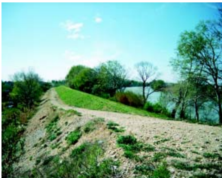
Photo 6.9 – Recharge drainante aval construite après la crue du 8 janvier 1994 sur la digue du Petit Rhône en Arles. Piste de service aménagée au sommet de la recharge – la crête de digue demeurant non carrossable.
