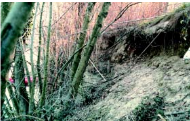
Photo 3.16 – Escarpement et arbres inclinés en berge ou sur le talus côté fleuve de la digue sont le signe d'une instabilité d'ensemble à la décrue.
