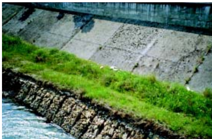
Photo 3.8 – Affouillement du pied de berge protégée sur le Gardon d’Alès – para fouille en gabions dans un état précaire.
