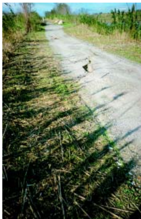
Photo 3.18 – Fissure apparue en crête de digue à la décrue de l'Agly en novembre 1999 – signe d'une instabilité du talus côté fleuve à la vidange rapide.
