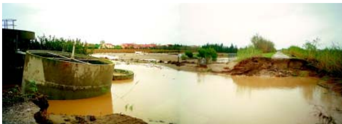
Photo 2.2 – en panoramique (auteur : Éric JOSSE, DDE 66) - Vue en coupe de la brèche par surverse de St-Laurent-de-la-Salanque sur la digue rive gauche de l'Agly et dégâts à la station d'épuration.
