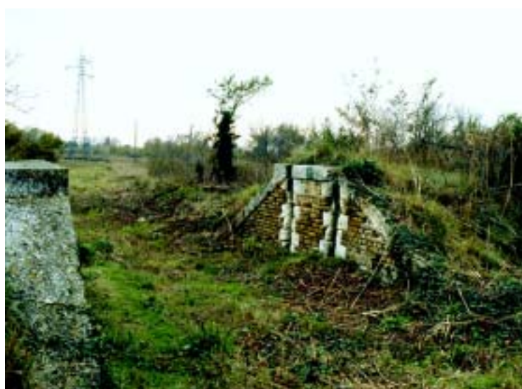
Photo 1.11 – Passage de chemin rural batardable dans la digue rive droite du Grand Rhône à Salins-de-Giraud (Bouches-du-Rhône).
