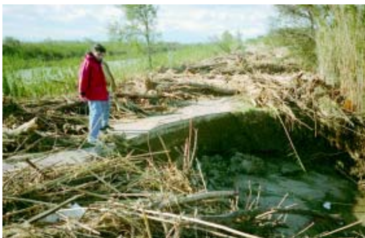
Photo 3.1 a (source DDE 66) - Dégâts dus aux surverses sur les digues de l'Agly, suite à la crue des 12-13/11/1999 : importante loupe d'érosion dans le talus, laisses de crue sur le couronnement.
