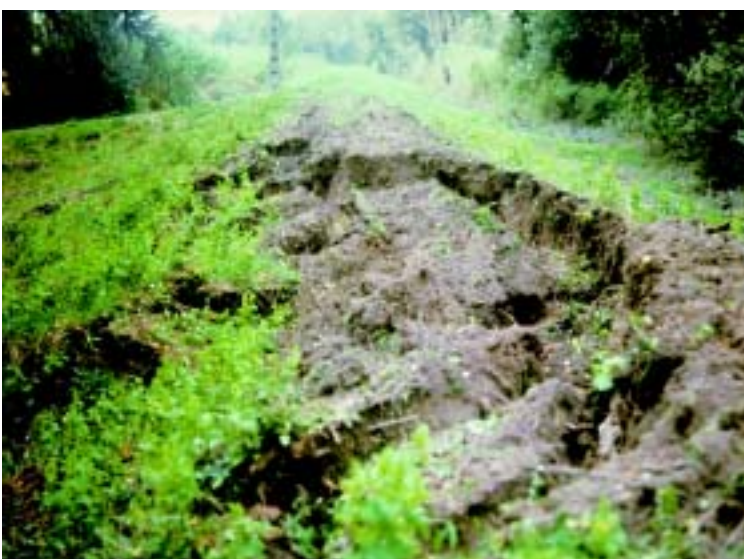
Photo 2.16 (source DDE 13) – Glissement d'un talus de digue interceptant la crête de l'ouvrage (digue de Camargue).
