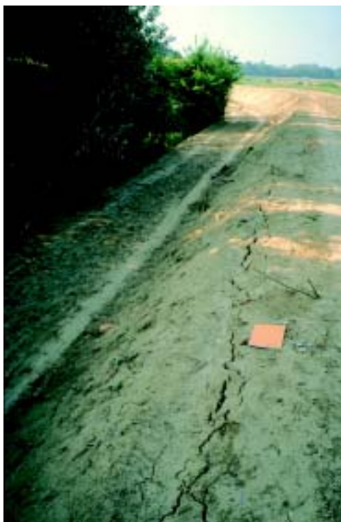
Photo 3.17 – Les pentes de talus trop raides (ici côté fleuve) exposent la digue à un risque d'instabilité.
