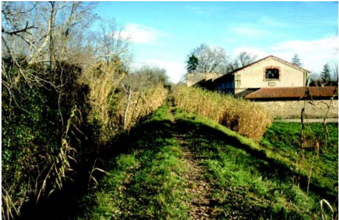
Photo 5.1 – La présence de végétation (ici cannes de Provence) rend très difficile l'inspection visuelle de cette digue du Petit-Rhône.
