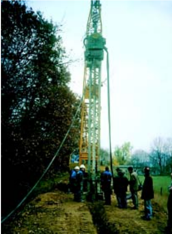
Photo 6.12 – Construction d'une paroi moulée étroite pour étancher le corps d'une digue (levée de l'Oder en Pologne).
