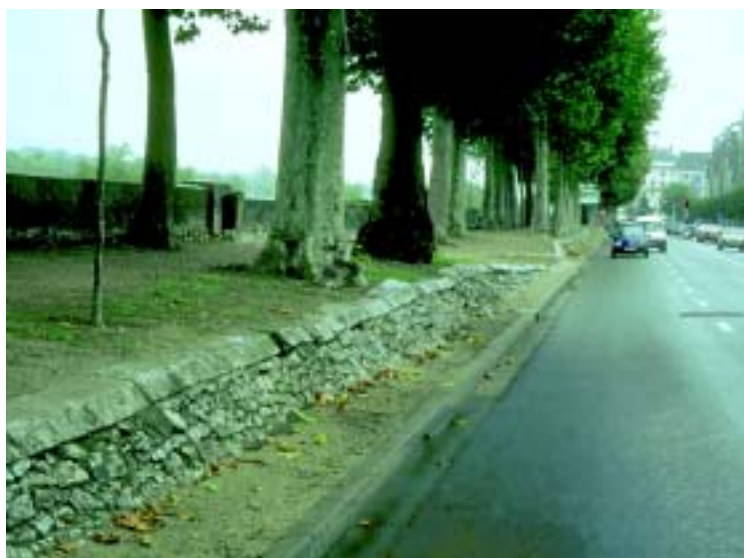
Photo 5.3 – Les racines des arbres déforment, et parfois même démantèlent, les maçonneries situées à proximité (quai de la Loire à Tours).
