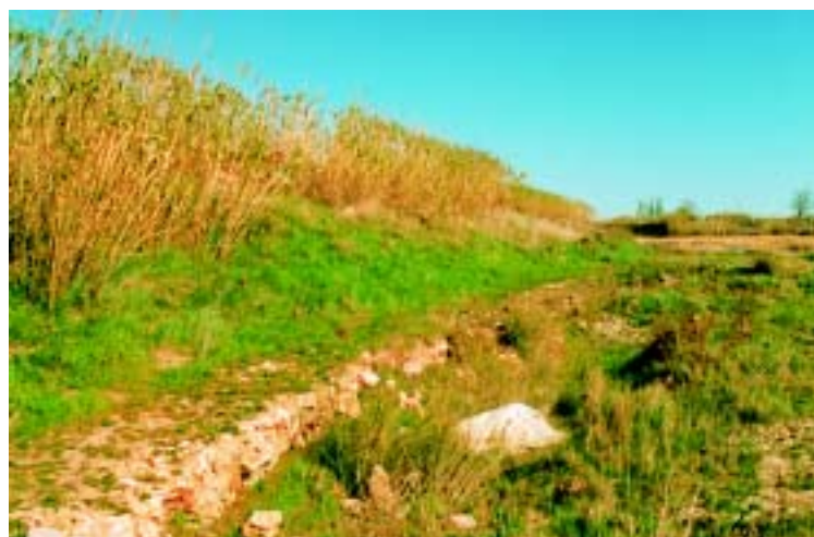
Photo 3.7 – Inspection des digues de l’Agly après la crue des 12-13/11/1999 : bêche para fouille en pied de berge mise à nue.
