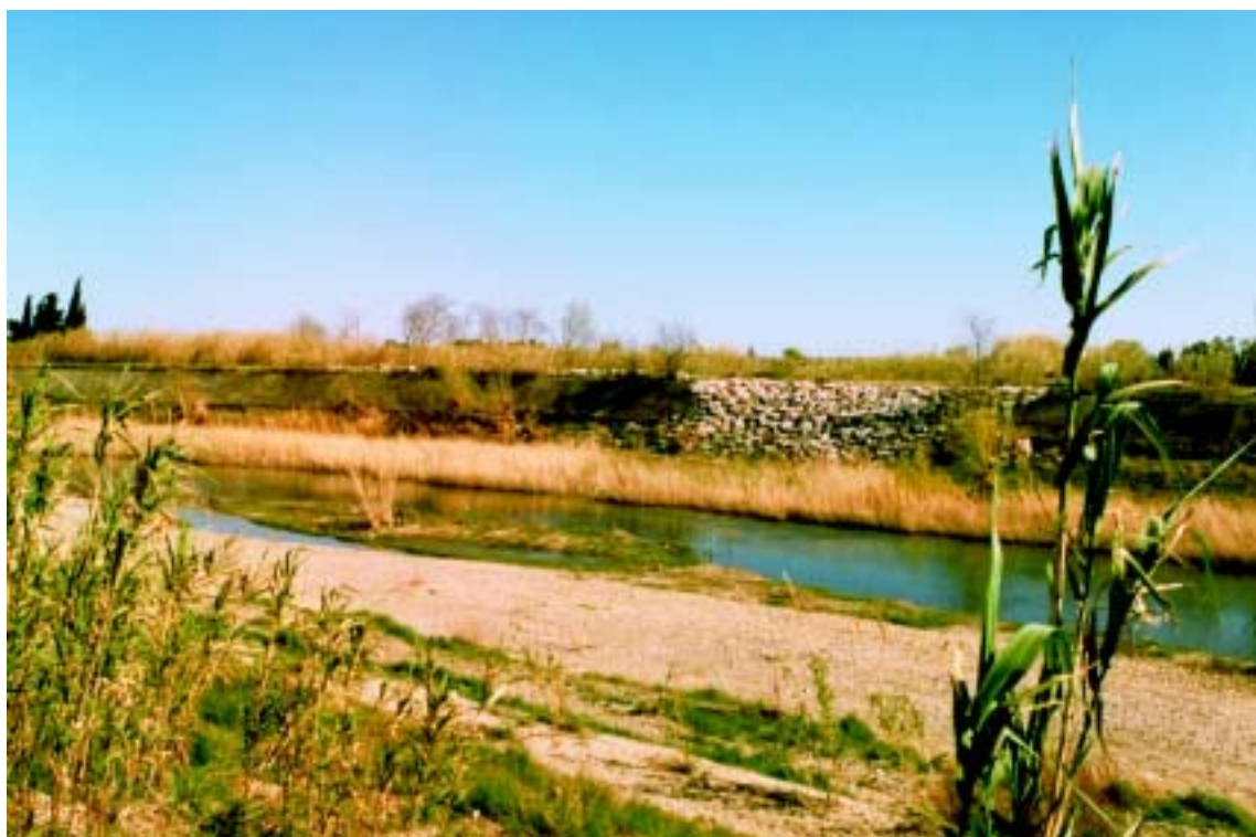
Photo 1.5 – Anciennes protections bétonnées de la berge et du talus côté fleuve de la digue rive droite de l'Agly (Pyrénées Orientales). Réparation récente en enrochements.
