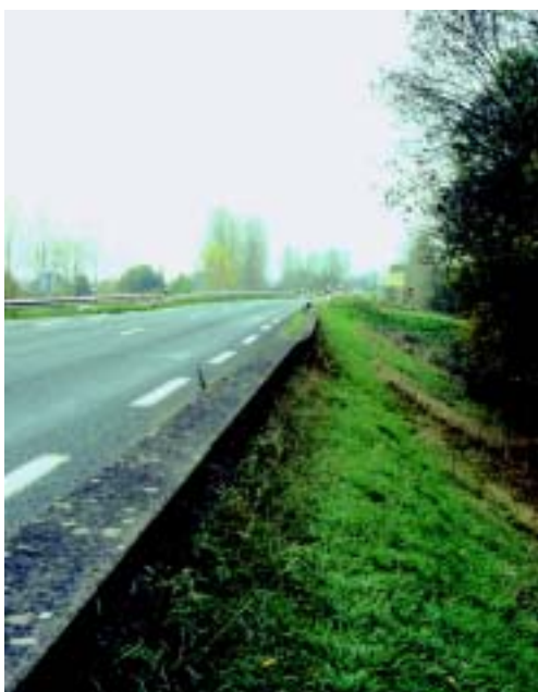
Photo 3.19 – Banquette de rehausse instable sur la levée du Val d'Authion (Maine-et-Loire)
