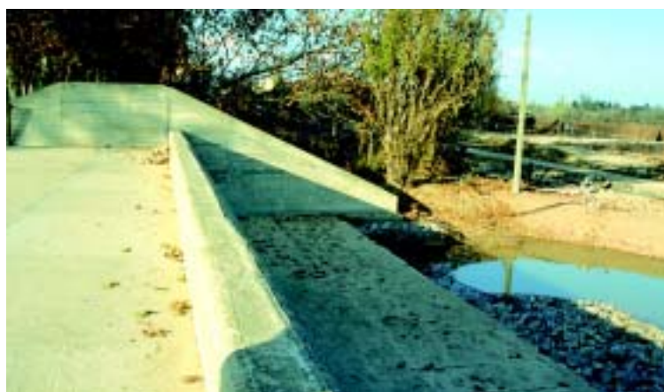
Photo 3.5 – Déversoir de Sallèdes d'Aude après la crue des 12-13/11/1999 : dégradations sur le radier parafouille en gabions.
